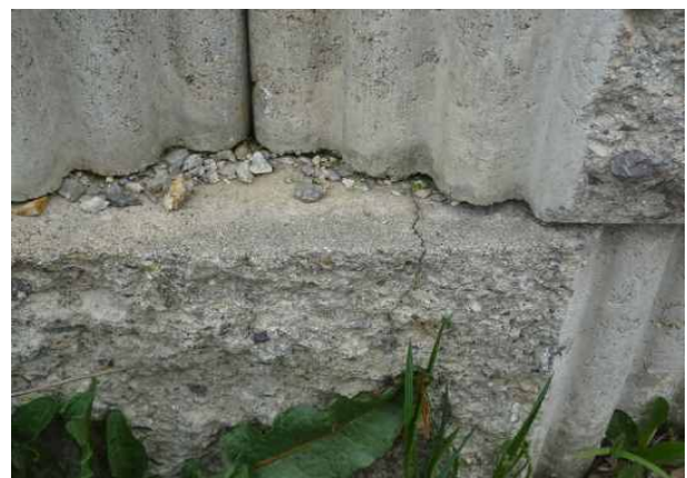
전면부 균열 11구간 0.1mm/0.2m
